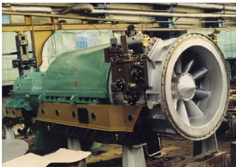
Рисунок 1 – Общий вид утилизирующей установки ГУБТ
