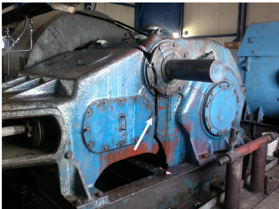
Рисунок 1 – Разрушение корпуса бурового насоса из стали 20ХГСФЛ
